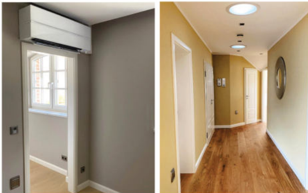
Moderne Klimatechnologie in einem Privathaus in Schleswig-Holstein Aufputzmontage, bei der die Rohrsysteme über die gesamten Wandflächen mit Gipskartonplatten verköffert wurden
