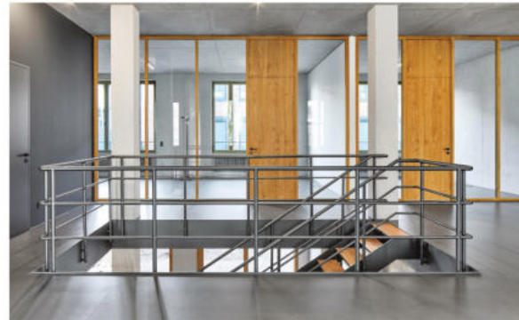
Bürogebäude „Schanzenlofts“, Häuser 1 und 2 Spachtel-, Grundier- sowie Lackierarbeiten an Stahltüren und -zargen, Vorarbeiten an den Fußbodenflächen und Anstrich der Setzstufen, Lackierarbeiten an Heizkörpern und -rohren
