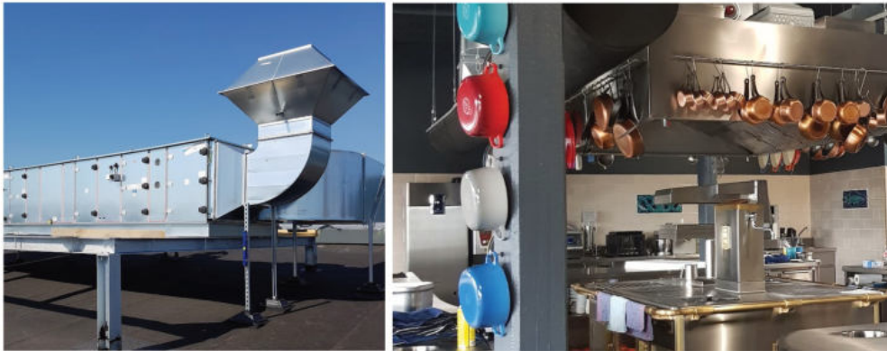
Ausstattung einer Großküche mit modernen Industrieanlagen
