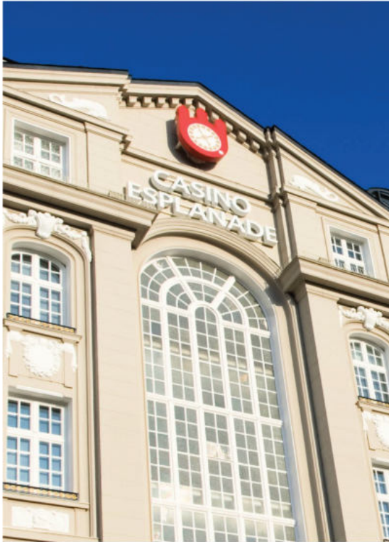
Casino Esplanade Reinigung der Fassadenflächen einschließlich Gesimsen, Kehlen, Zier- und Stuckelementen und Beschichtung mit Kalziumsilikatfassaden-system. Lackieren der Brüstungsgitter, Vergoldung der Ornamente mit Blattgold, Aufarbeitung der Fenster
