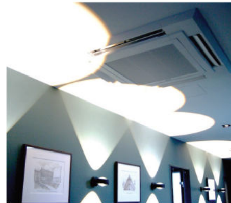
Komfortklimaanlage in einem Bürogebäude in Hamburg
